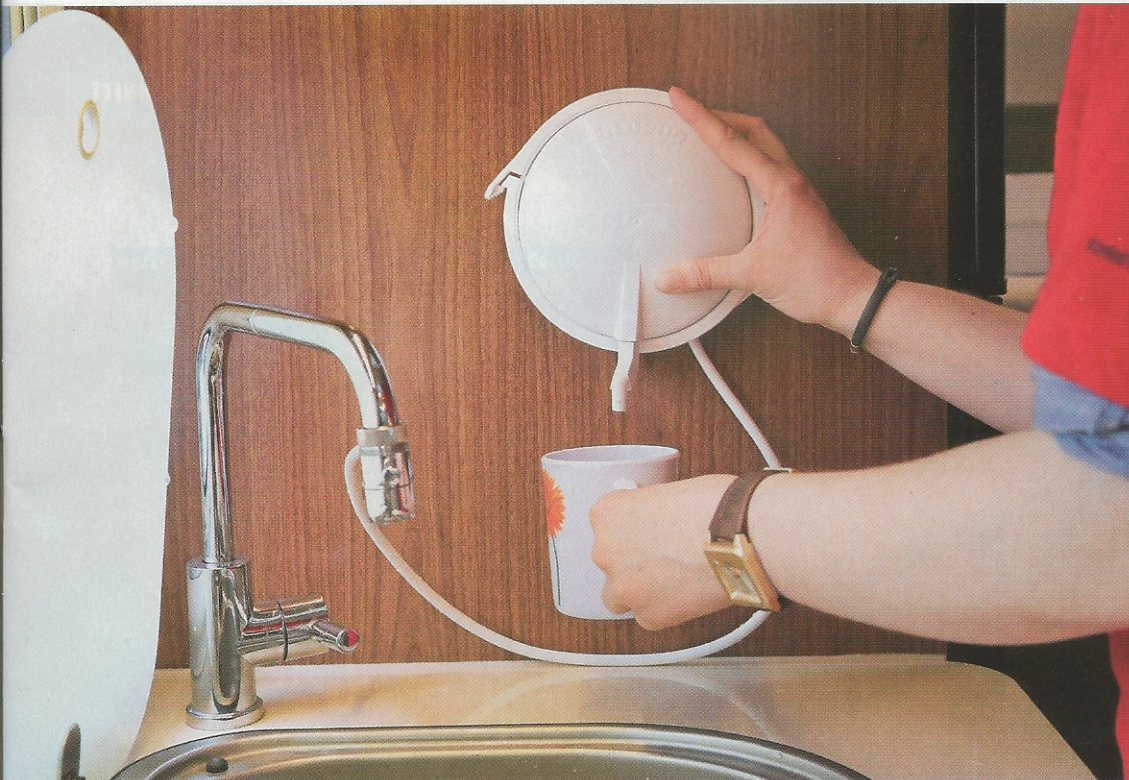
Angeflanscht: Die Wasseraufbereitung an der Entnahmestelle erfordert nur minimalen Installationsaufwand.
